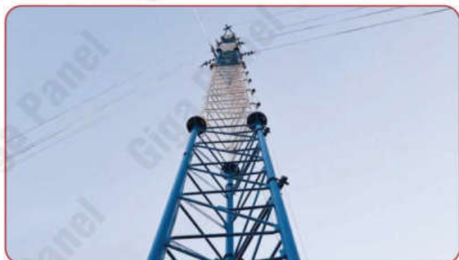
Trụ dây co Guyed tower
